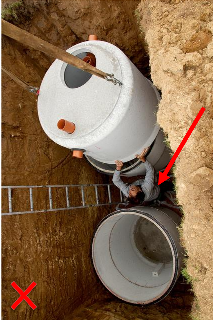
Hombre en excavación sin protección instalando un tanque séptico. Riesgos serios de derrumbe existen en ésta situación. (*2)
