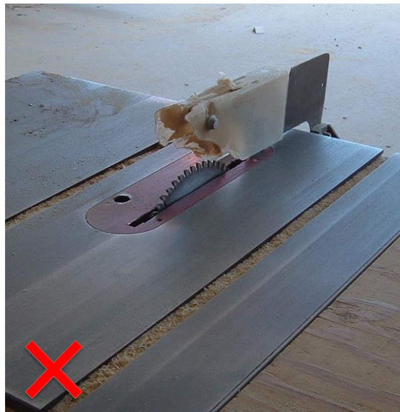
Mesa con hoja de sierra sin protección; guarda dañada.
