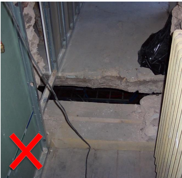
Agujero en el piso sin protección. (*2)
