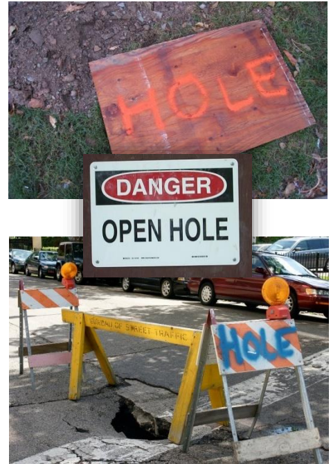
Ejemplos de señales de peligro, cubiertas y barricadas. (*10, *11, *12)
