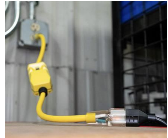
GFCI Conectado a Cable
