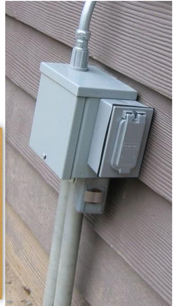
Instalación permanente de toma de corriente GFCI al aire libre y cubierta protectora. (*6)
