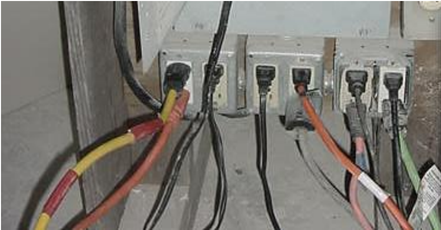
Preparación temporal común de un panel eléctrico con tomas de corriente GFCI encontrados en un sitio de construcción.
