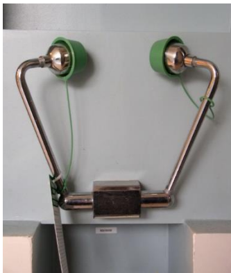
Estación de lavado de ojos. (*10)
