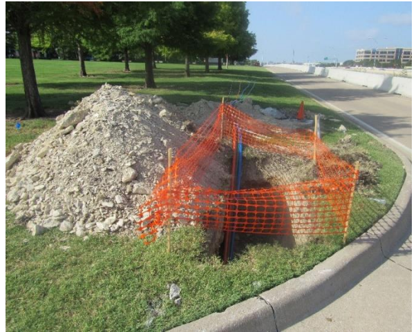
Cerca naranja usada en esta foto como una advertencia para los riesgos potenciales de tropezos y caídas cerca de esta excavación.
