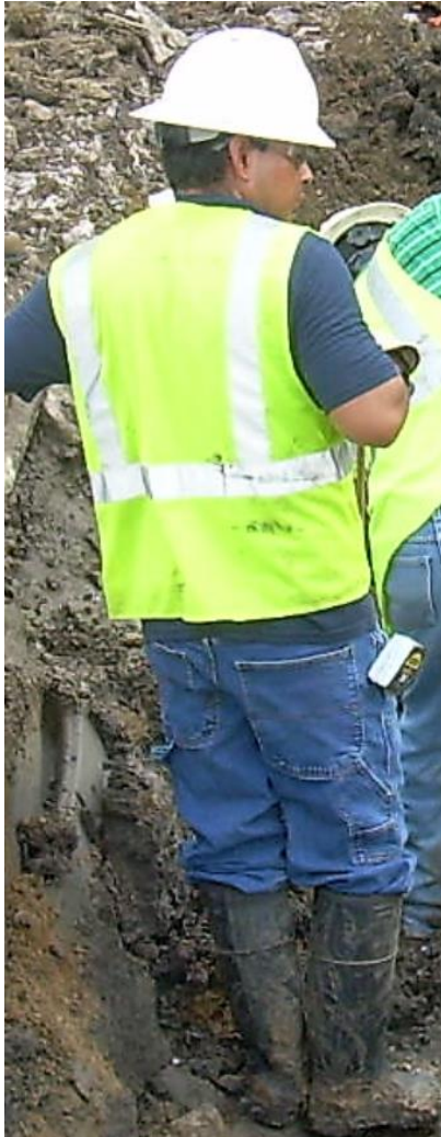
Trabajador usando botas de goma con punta de acero, al trabajar en una zanja poco profunda.
