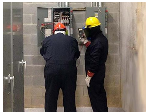
Trabajadores eléctricos usando PPE adecuado. (*7)
