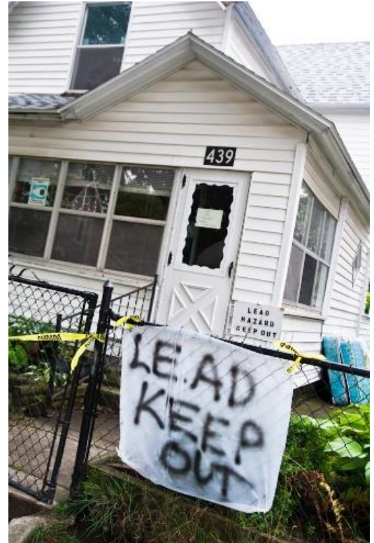
Contaminación de plomo encontrada en este sitio de construcción pesada. (*2)
