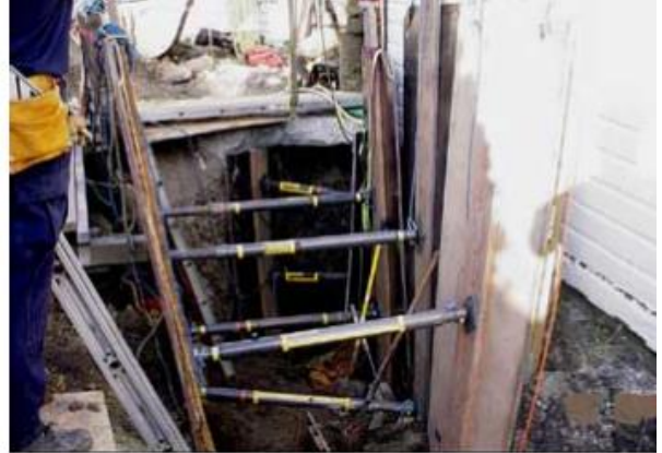
Escena de un derrumbe de zanja fatal después de que se instaló protección para derrumbes para remover el cuerpo del trabajador fallecido de manera segura. (*2)
