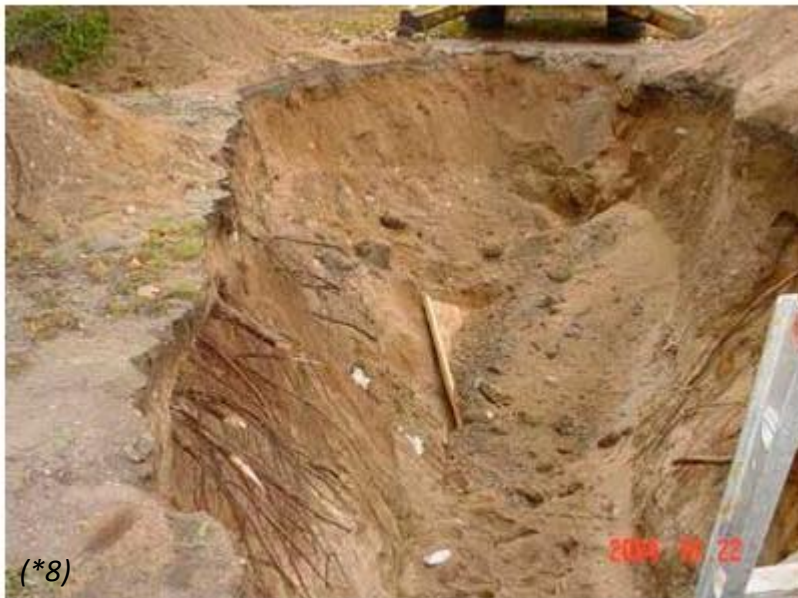
Figura 1. Foto de una Zanja después de un derrumbe.
