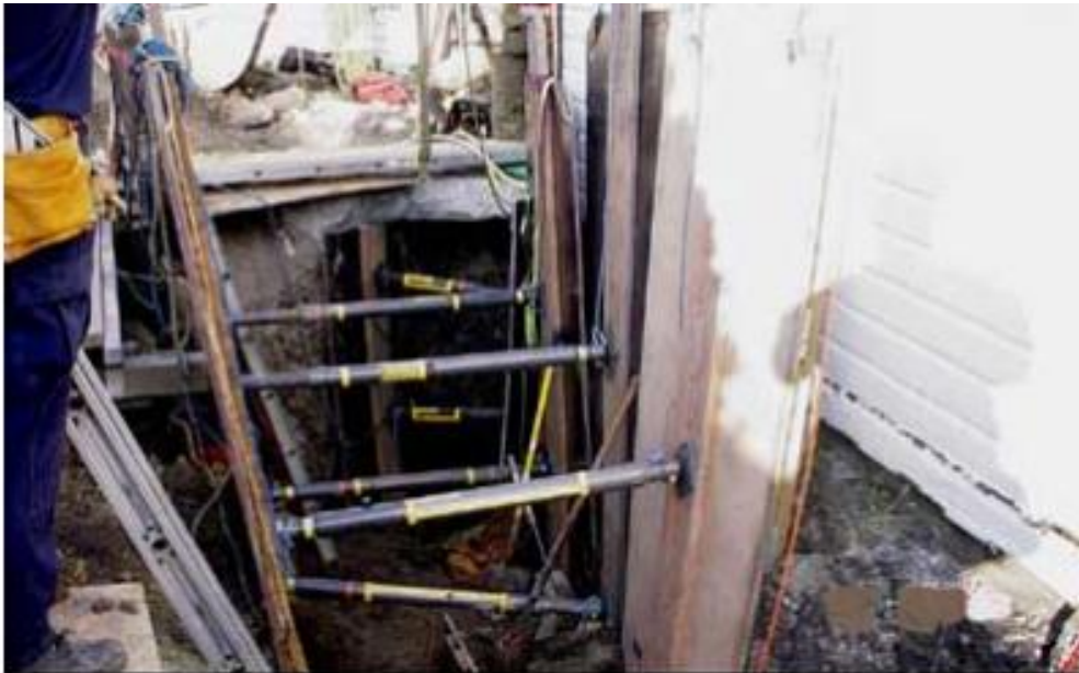
Escena de un derrumbe de zanja fatal después de que se instaló protección para derrumbes para remover el cuerpo del trabajador fallecido de manera segura. (*2)
