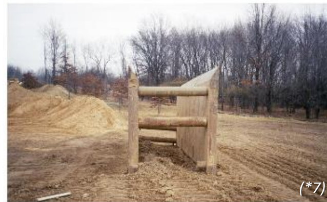
Figura 2. Escudo (El escudo fue removido de la zanja con una excavadora y colocado a 20 yardas de la zanja.)
