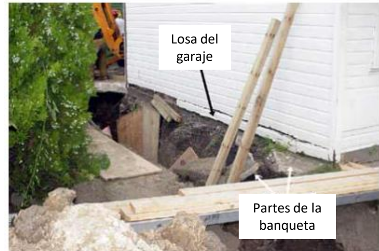
Dos vistas de la escena del derrumbe de zanja fatal. Nota que no hay protección puesta para evitar los riesgos de derrumbe. (*3, 4)
