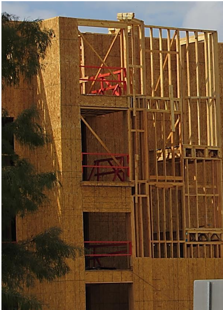
Barandales instalados y mantenidos.
