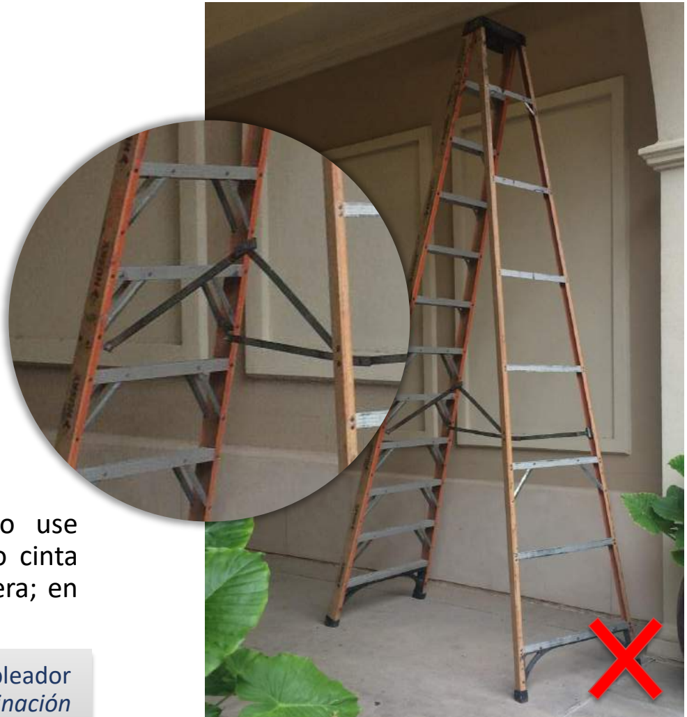
Escalera con un candado de ensamblaje quebrado en un lado y candado de ensamblaje suelto en el otro lado. La escalera también tiene calcomanías y etiquetas del fabricante faltantes que proveen las calificaciones y advertencias de seguridad.
