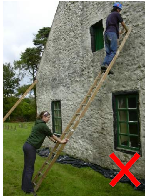
La escalera en ésta foto se encuentra en un ángulo inseguro. (*4)
