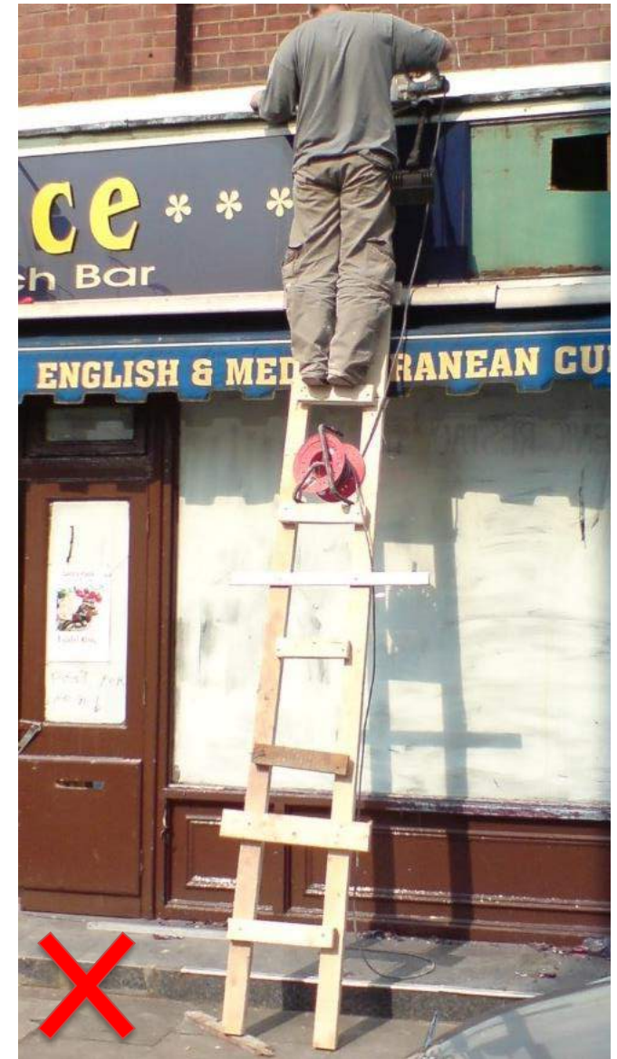
Escalera insegura hecha en el trabajo. (*1)
