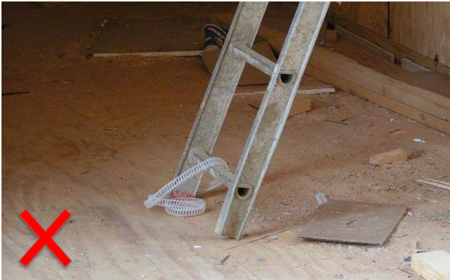
Escalera extensible con montaje de pie y placas faltantes. Esto parece ser la porción superior de una escalera extensible que ha sido separada.
