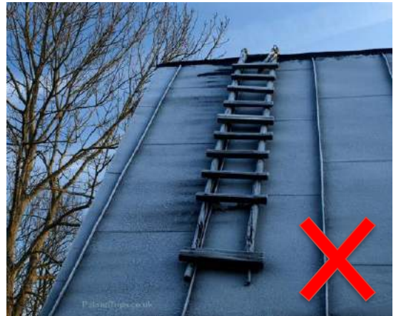
Ésta escalera fija improvisada no está construida adecuadamente y está visiblemente dañada. (*6)
