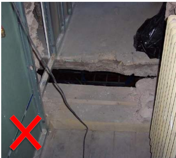
Agujero en el piso sin protección. (*1)
