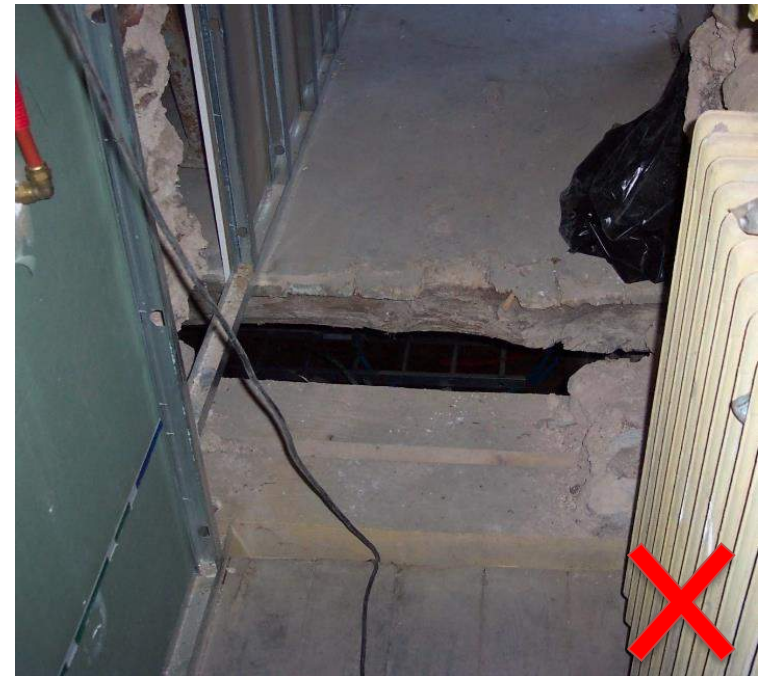
Agujero en el piso sin protección. (*1)
