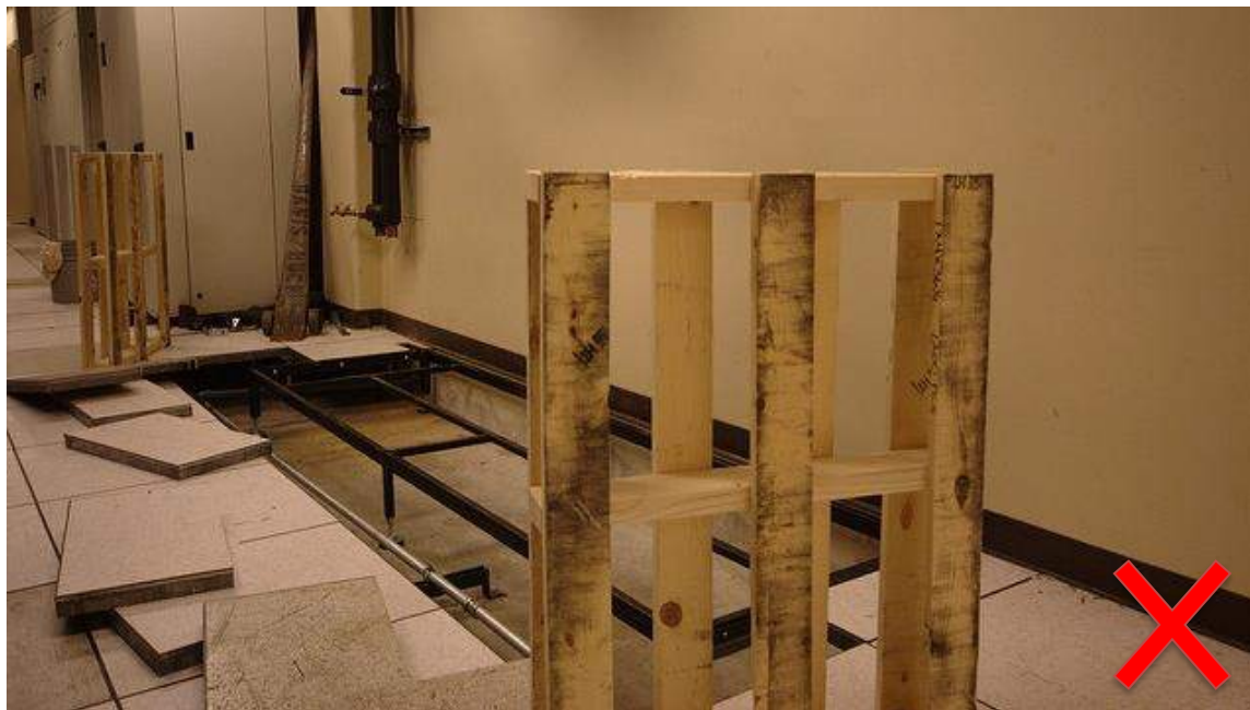
Abertura en el piso sin cubierta ni sistema de barandal. (*2)
