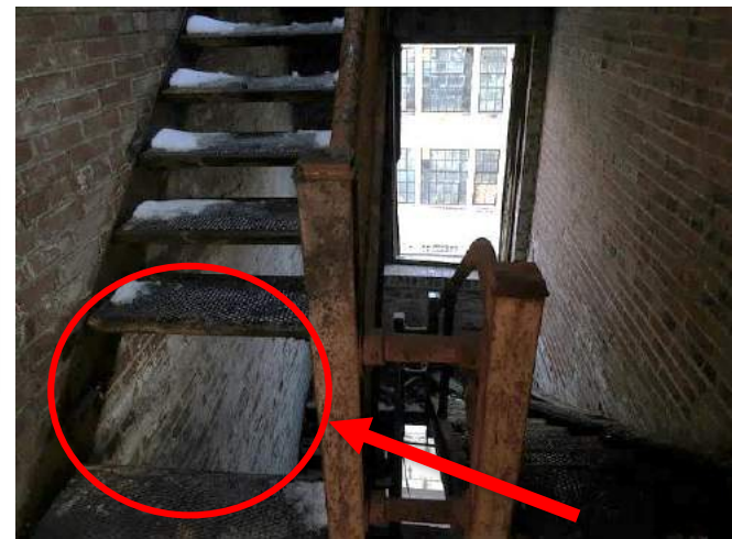
Escalón faltante que necesita protección o reparación. (*3)
