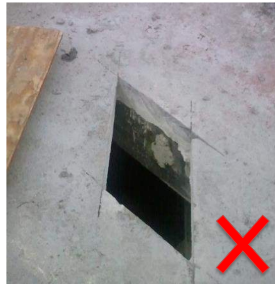
Entrada sin protección en cubierta. (*11)
