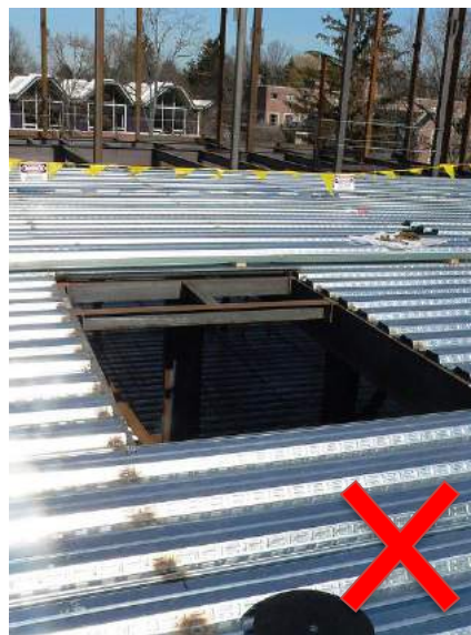
Agujero sin resguardo en techo (*10)
