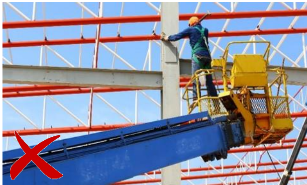
Nunca trepe los barandales.
