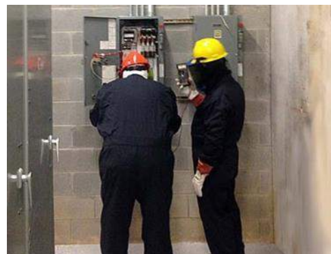
Trabajadores eléctricos usando PPE adecuado. (*7)
