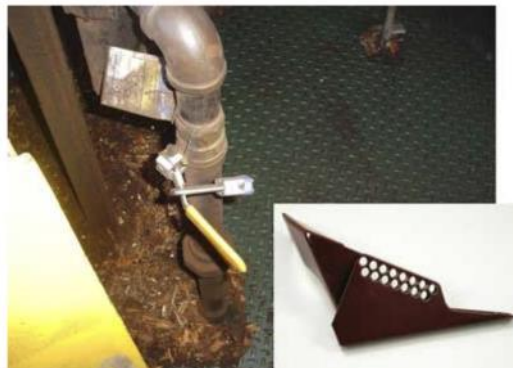
Foto 4. Esta foto ilustra la línea de aire que suministró a la descortezadora y no está bloqueada adecuadamente. El inserto ilustra un ejemplo de un dispositivo de bloqueo de válvula de bola que puede ser usado para bloquear la línea de aire neumática. Las direcciones del fabricante para instalar cualquier dispositivo de bloqueo deben ser seguidas.
