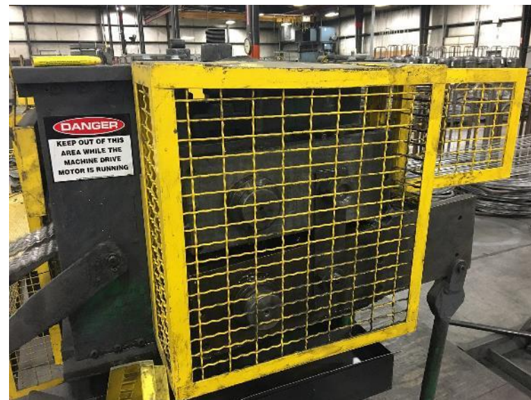
Protección de puntos alrededor de la operación de engranaje de la máquina. (*7)
